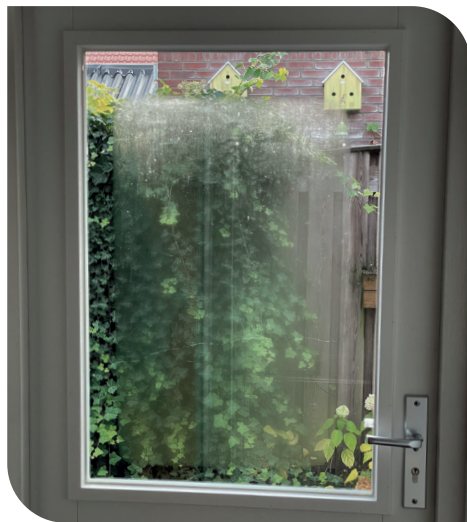
Condensvorming aan de kamerzijde.
